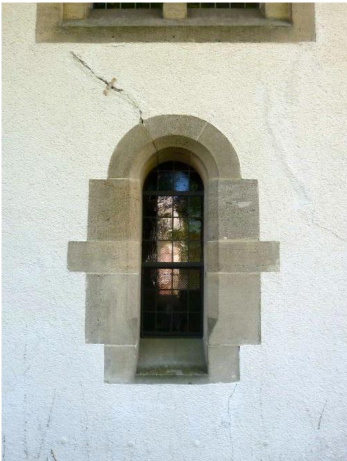
„Risse im Putz stören die Ansicht erheblich.“
